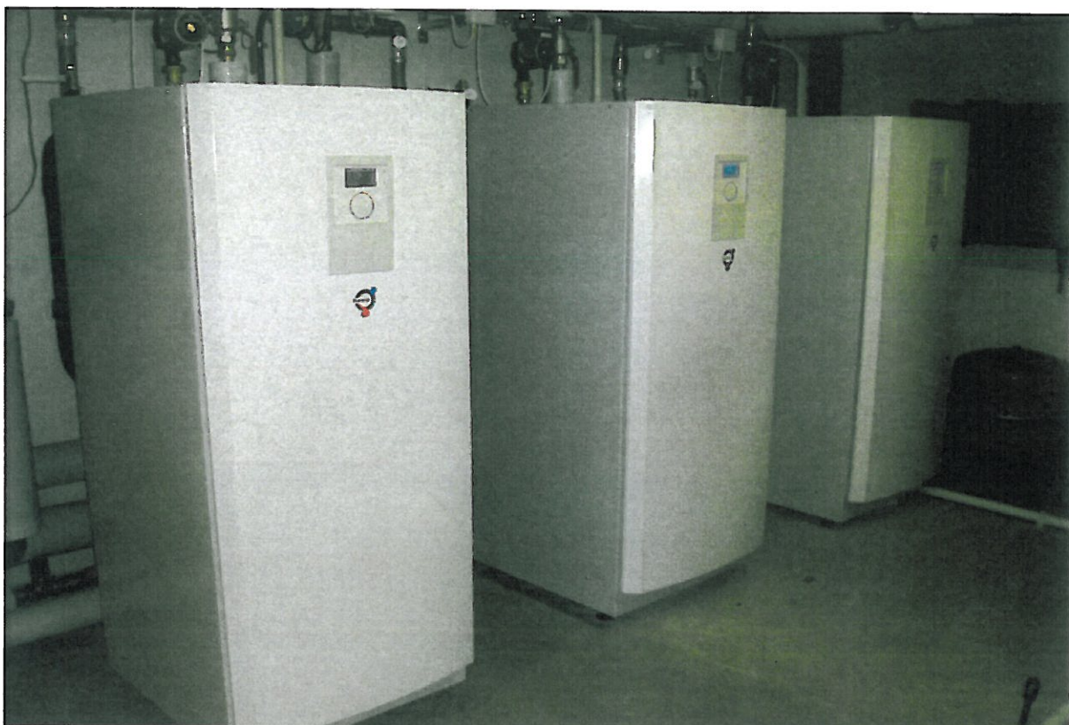
Bergvärmeanläggning, kv. Betslet
