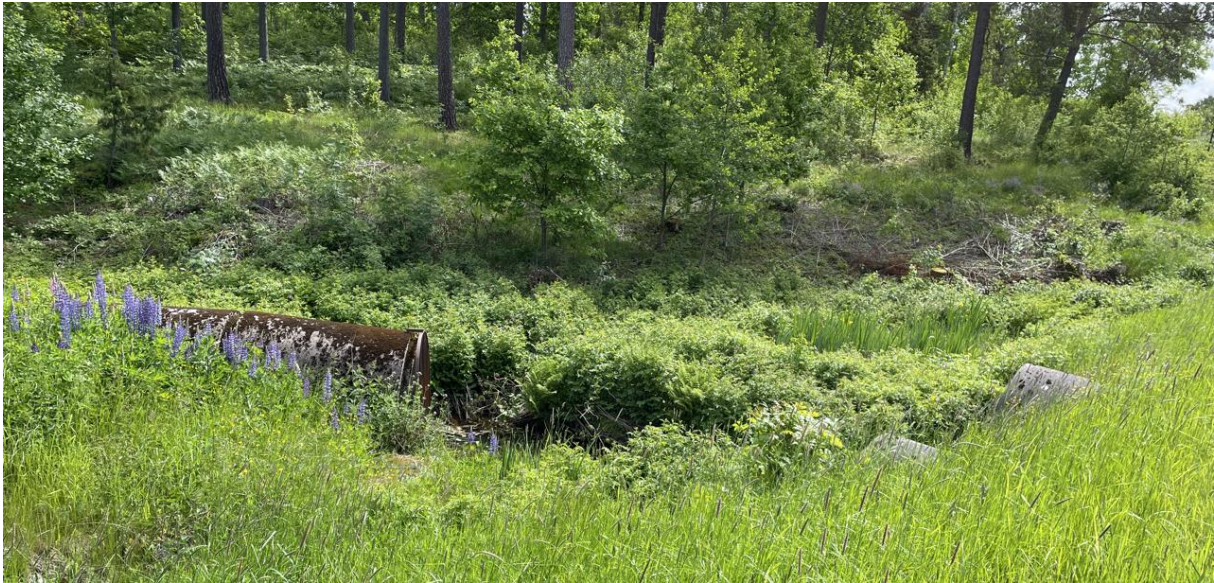
Figur 8. Bilden visar dagvattenledningen till vänster samt två 2000 mm trummor till höger, trummorna fortsätter under motorvägen för att sedan mynna ut i Åmålsån.
