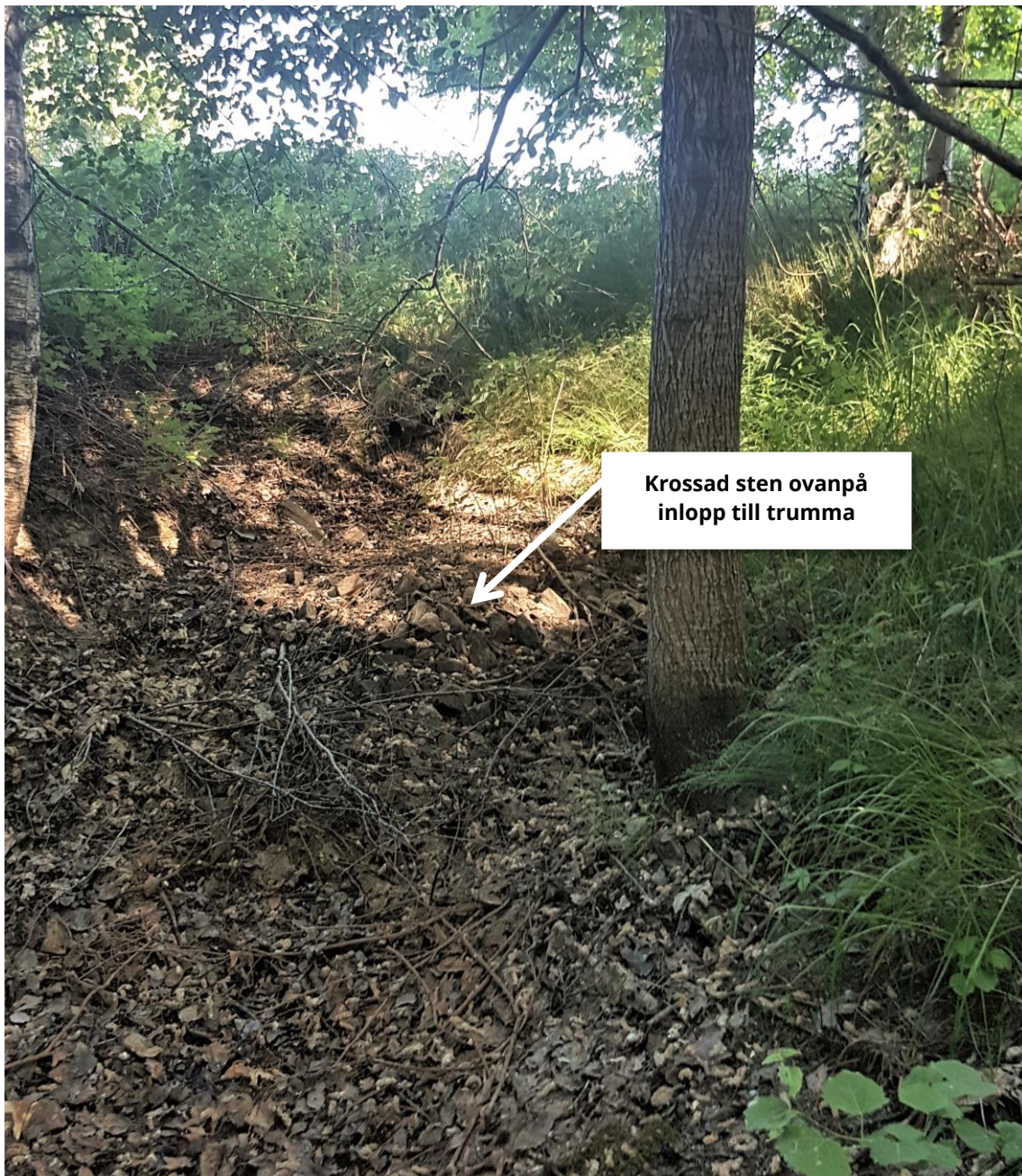
Figur 6. Dikets krossstensfyllda utlopp. Under högen av krossad sten finns en trumma som leder dagvattnet till en ravin norr om Strömstadsvägen ca 50 meter bort.
